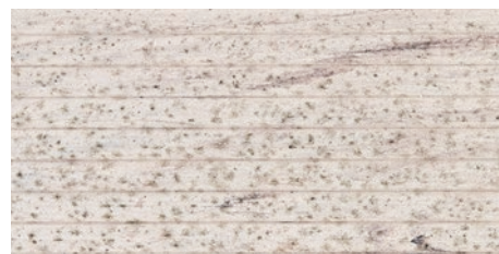
Stockflecken/Schimmel auf der Oberfläche
